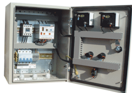
514 TRIFASICO CON VOLTIMETRO Y AMPERIMETRO
